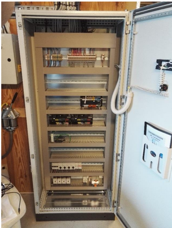
Figur 18 Ny styretavle i energisentral
