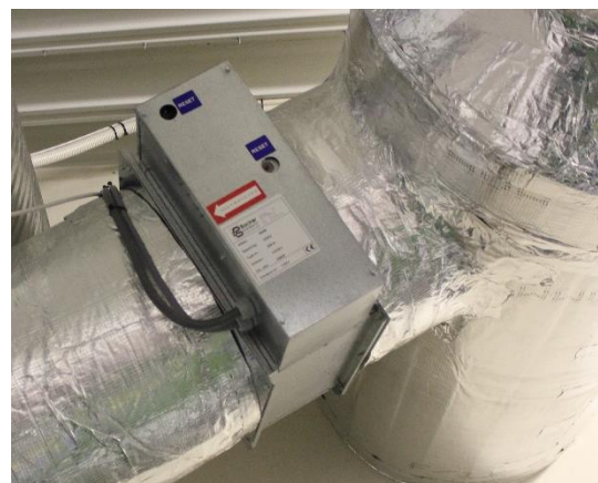
Figur 30 Ettervarmebatteri i tilluftskanal
