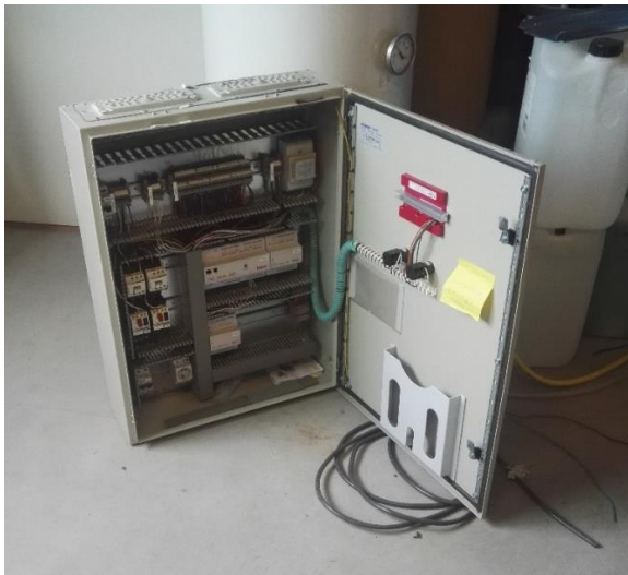
Figur 17 Gammel styretavle i energisentral
