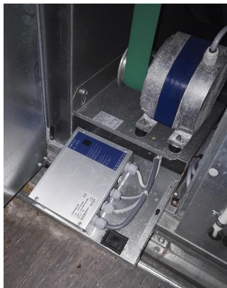
Figur 44 Frekvensomformer til roterende varmegjenvinner
