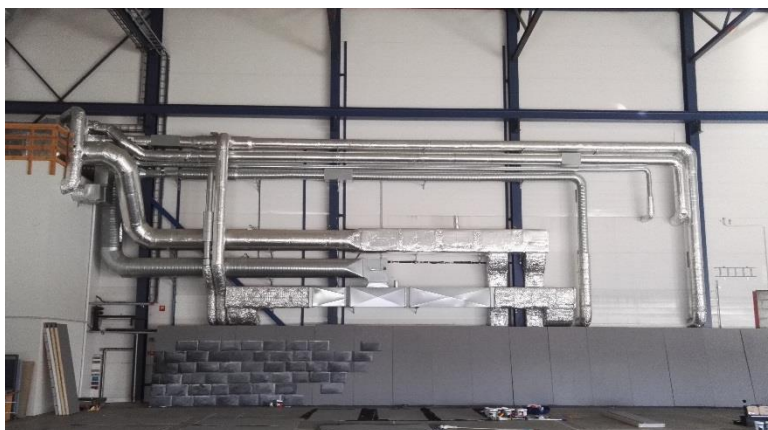
Figur 40 Ventilasjon i lagerhall
